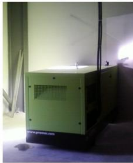
Fig.19 b) Sala de Energia
