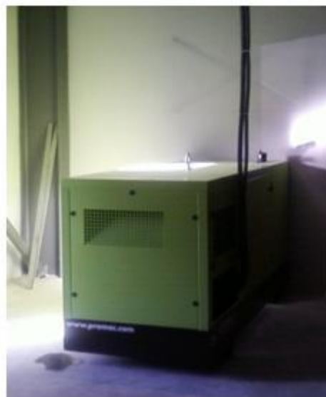
Fig.19 b) Sala de Energia
