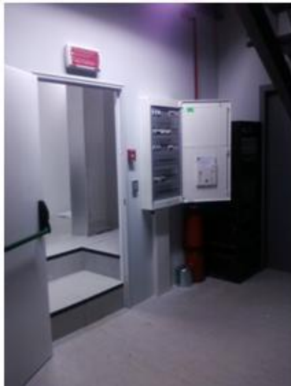
Fig.19 a) Sala De Telecomunicações
