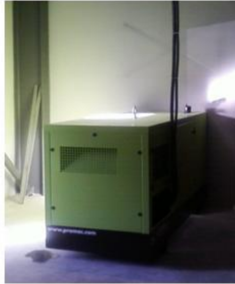
Fig.19 b) Sala de Energia
