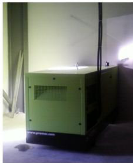
Fig.19 b) Sala de Energia
