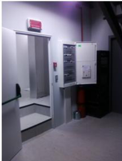
Fig.19 a) Sala De Telecomunicações
