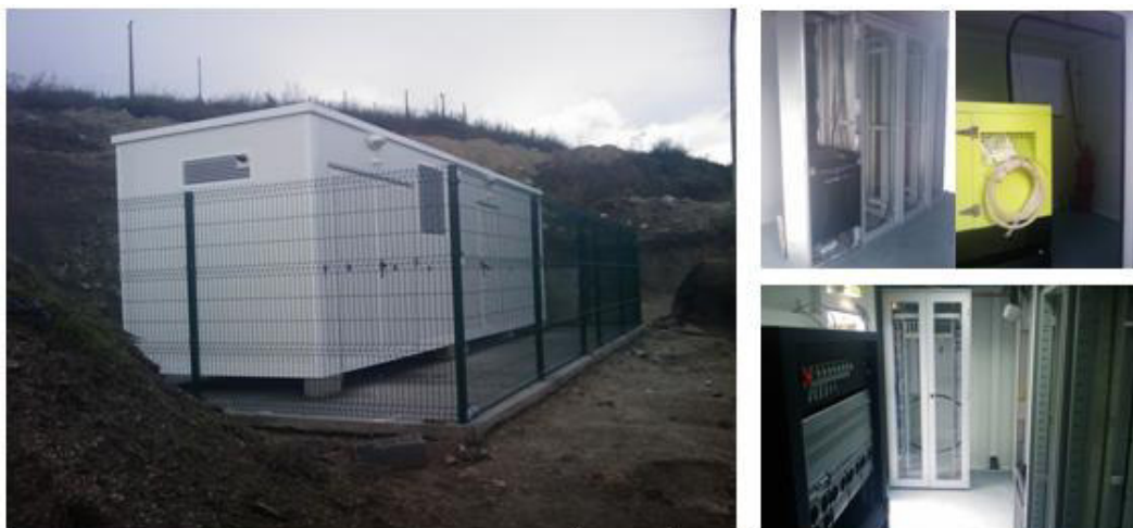
Fig.22 – POP de Ponte da Barca
