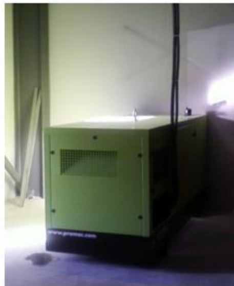
Fig.19 b) Sala de Energia
