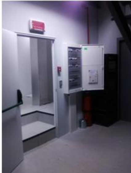
Fig.19 a) Sala De Telecomunicações
