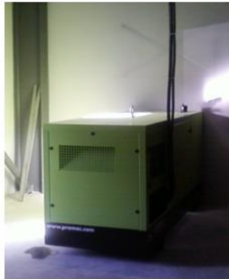
Fig.19 b) Sala de Energia
