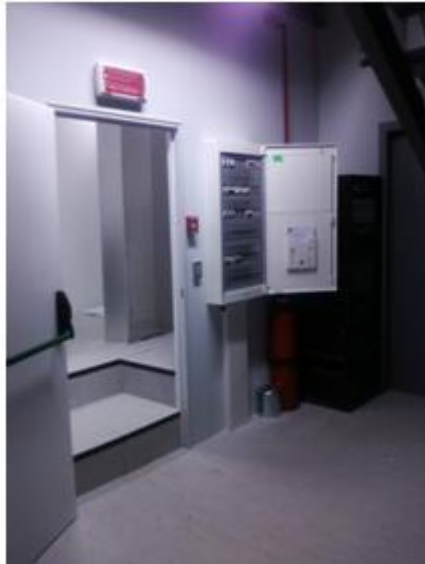
Fig.19 a) Sala De Telecomunicações
